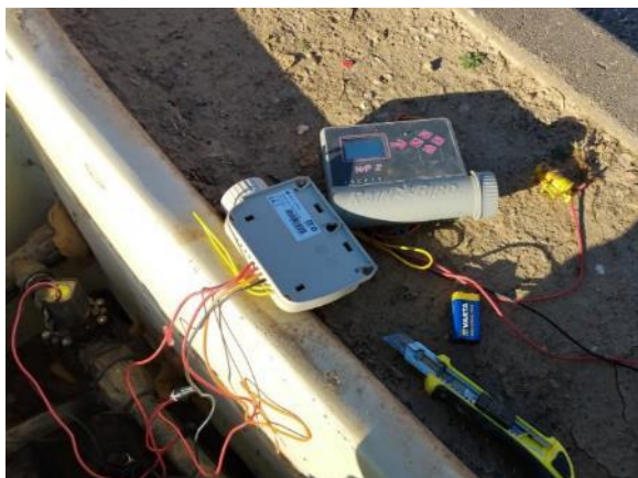
Vial Ppal. mediana - frente Hotel (cambio programador Rain Bird por Solem de 2E)
