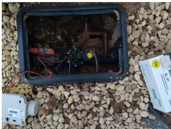
Fuente entrada - Nueva instalación (nueva arqueta, electroválvula 1" y programador Solem 1E)
