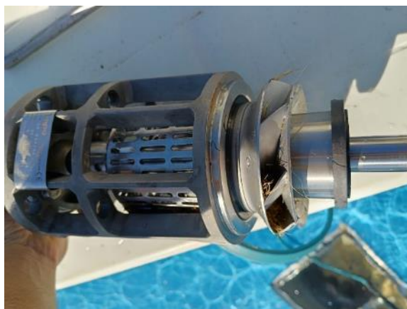
Fuente entrada - Limpieza por acumulación de residuos en tobera cuerpo hidráulico
