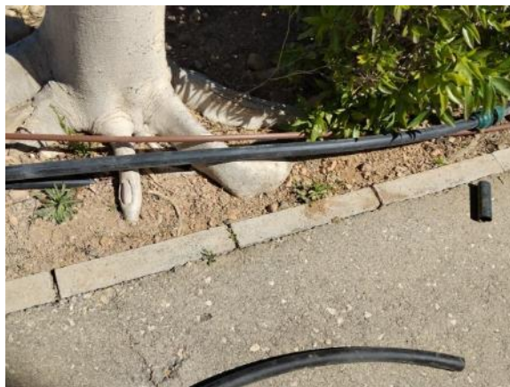
Fase 7 Oasis - Fuga por estrangulamiento raíces frente apartamentos nuevos (1,5 ml PE Ø32 y 2 enlaces)
