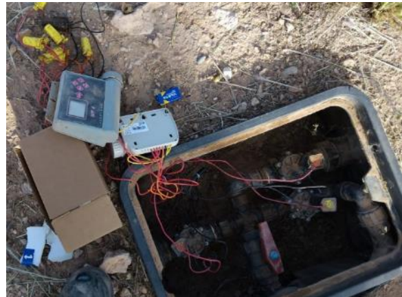
Vial ppal. - Parterre junto parking Casa Club (reposición programador Rain Bird roto por Solem 4E)
