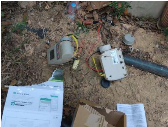
Vial ppal. - Garita vigilantes junto poste alumbrado (cambio programador Solem 1E)
