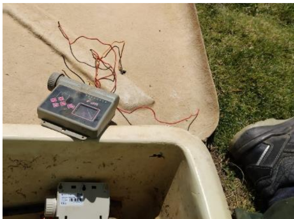
Vial Ppal. (entrada) - Rotonda Olivo (cambio programador Rain Bird 4E por uno Solem 4E y 1 pila 9V)
