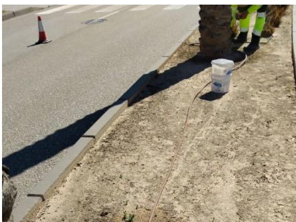
Vial Ppal. - De rotonda grava negra a Casa Club (22 ml PE Ø16, 32 goteros y 18 enlace)
