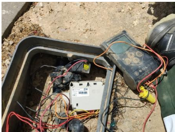
Vial Ppal. Izq.- Mantenimiento (reposición programador Solem roto por nuevo SOLEM)
